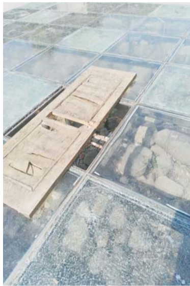
小广场地面玻璃破损
