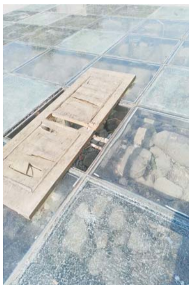
小广场地面玻璃破损
